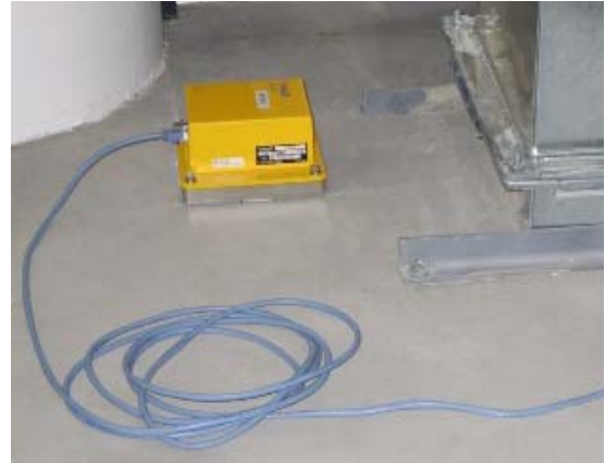
図4 建物内の地震計の設置状況
